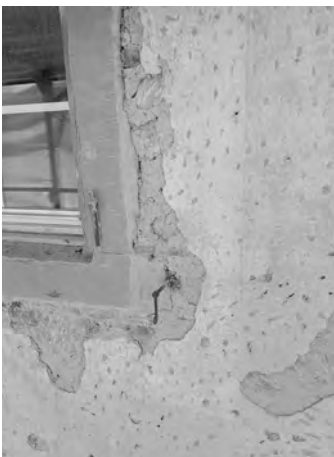
Auch um die Fenster ist die helle Rahmung erkennbar, bisher verborgen unter dem „alten„ Putz.
