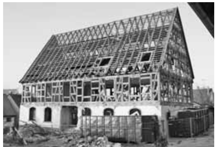
Ansicht auf das künftige Bürger- und Vereinshaus Harmonie aus südwestlicher Richtung. Die Entkernungsarbeiten schreiten zügig voran.
