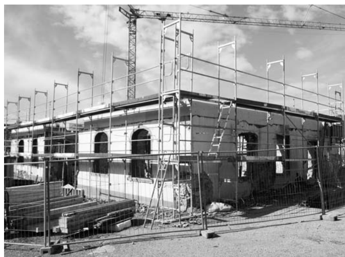
Direkt über den Fensteröffnungen verläuft der Betongurt, der künftig die Stahlbetondecke des Bürgersaales tragen wird.
