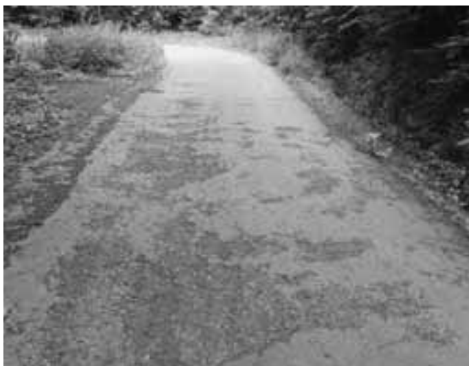
Im jetzigen Zustand kann die Asphaltdecke noch saniert werden. Bei stärkerer Beschädigung bleibt nur ein teurer Vollausbau
