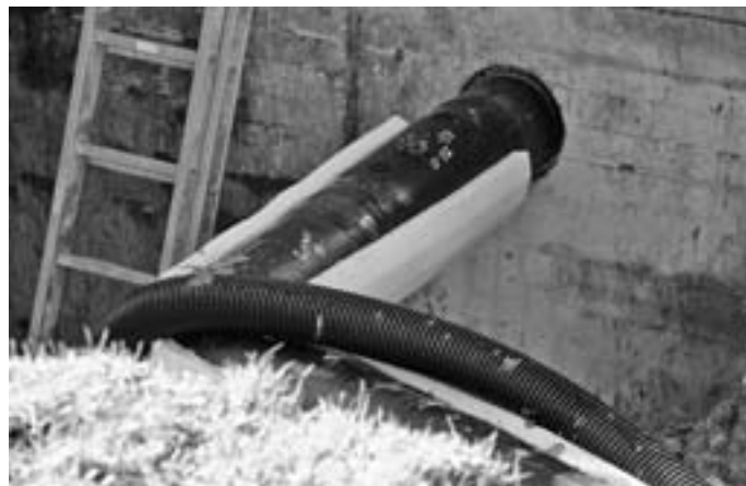
An dieser Stelle der Schlossparkschule beginnt die Fernwärmeleitung zur städtischen TSV-Halle. Die Rohre sind mit einem Dämmmaterial mit höchstmöglicher Wärmedämmung ausgestattet.
