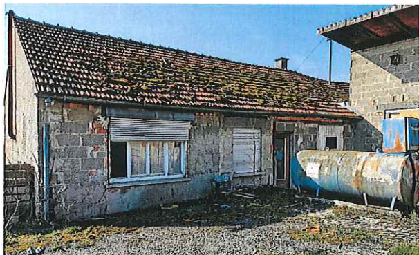
Abb. 5: Dienstgebäude mit aufgebrochener Eingangstüre
