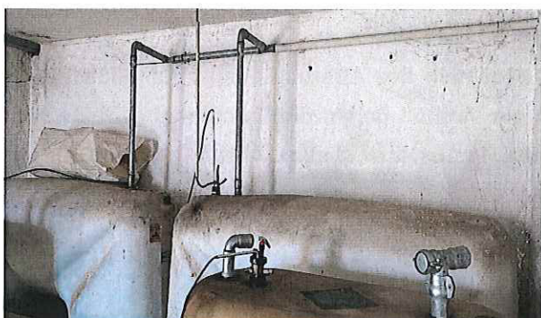
Abb. 18: Technikbereich mit Öltanks
