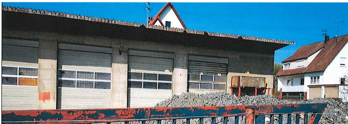
Abb. 22: Eternitdeckung der Fahrzeughalle und Schottermiete als Brutstätten für Vogelarten
